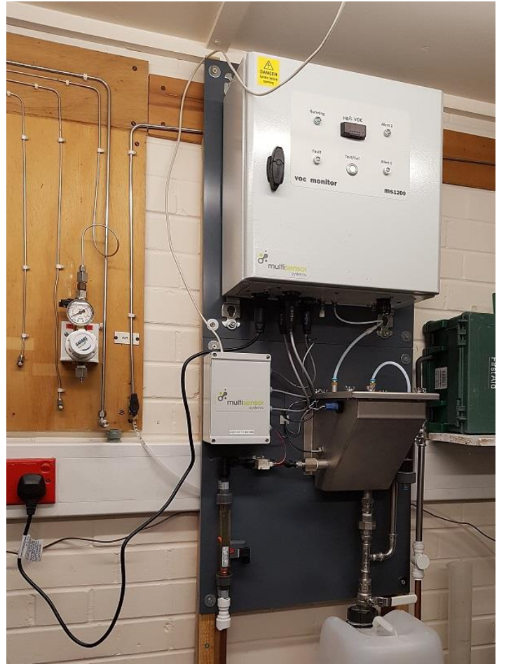
Resim 15 - Ek binada kurulu ünitenin bir resmi. Ünite, verileri kaydeden ve bir kaza durumunda emme pompalarını kapatan bir alarmı tetikleyen bir PLC'ye bağlıdır.
